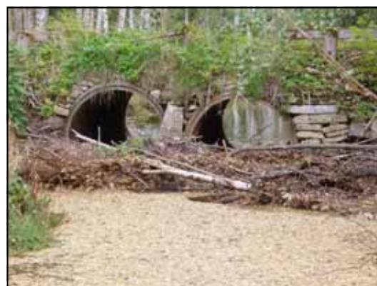
Figur 5. Bäverdam som utgör vandringshinder (tabell 3, hinder 4).
